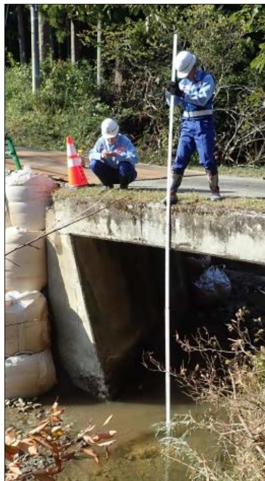
福島県南相馬市北鳩原飯盛線 道路被災状況調査（道路調査班）
