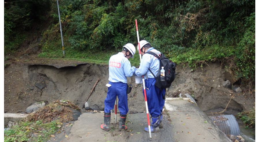
宮城県伊具郡丸森町 後沢川 被災状況調査(道路調査班)
