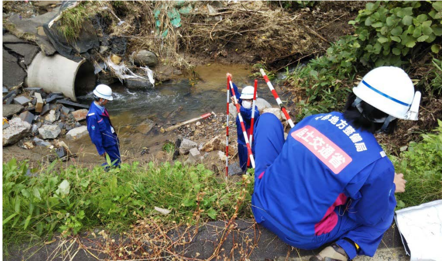
岩手県丸森町 護岸崩壊 被災状況調査(河川調査班)
