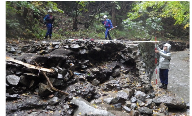
岩手県普代村 林道流出・護岸崩壊 被災状況調査
