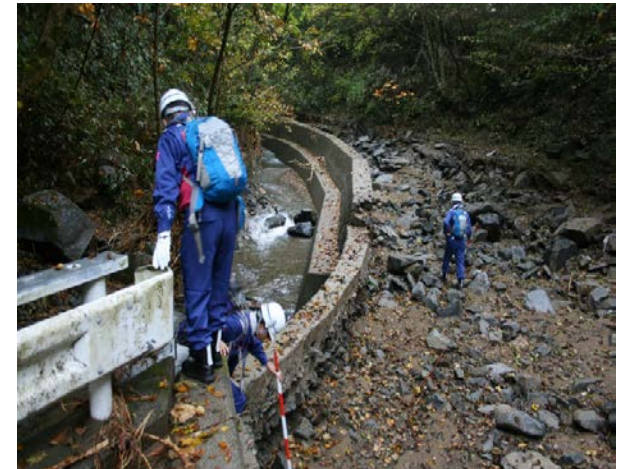
岩手県普代村 普代田野畑線 被災状況調査
