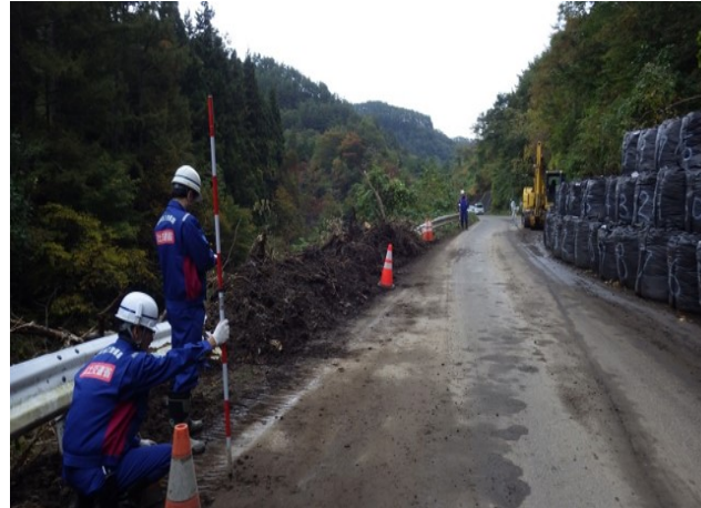
岩手県田野畑村 島越浜岩泉線 被災状況調査
