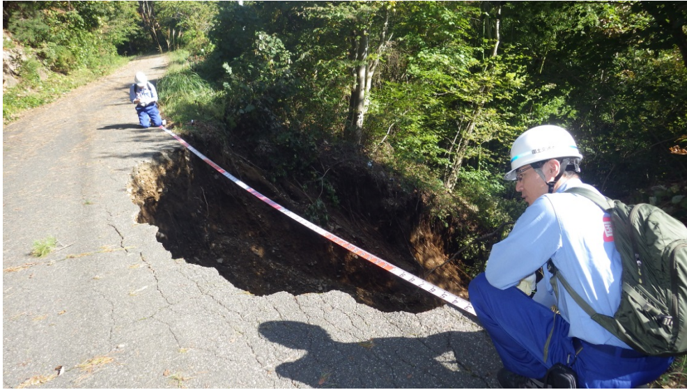
宮古市松月地区 被災状況調査
