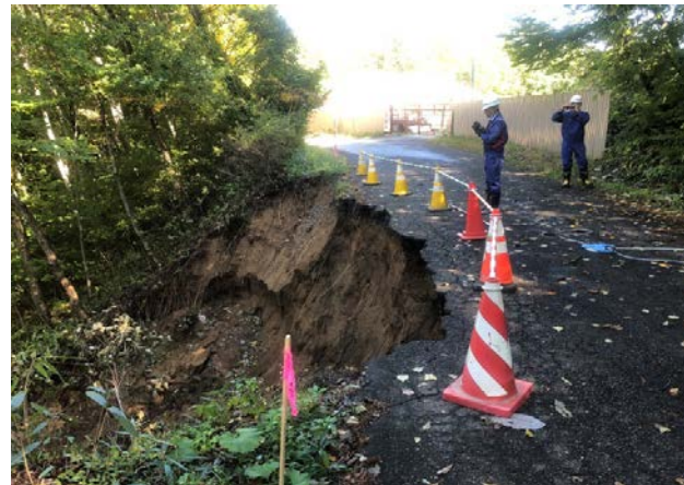
岩手県下閉伊郡普代村 普代向野場線 法面崩落箇所 被災調査
