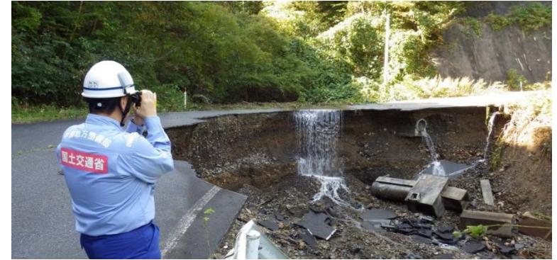
岩手県下閉伊郡田野畑村 被災状況調査
