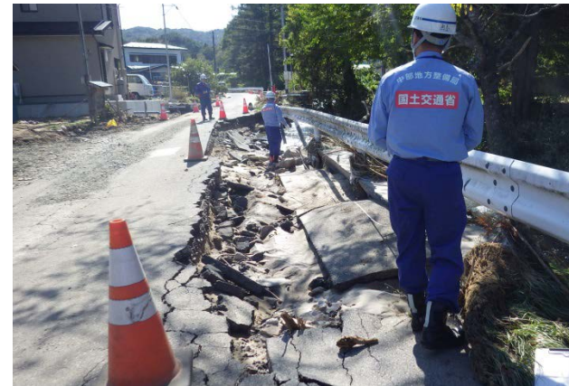
岩手県山田町 被災状況調査
