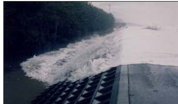
平成9年9月台風20号 越波による浸水 (焼津工区一色地先)
