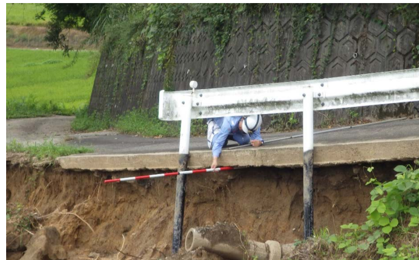
多久市内における被災状況調査(道路調査1班)
