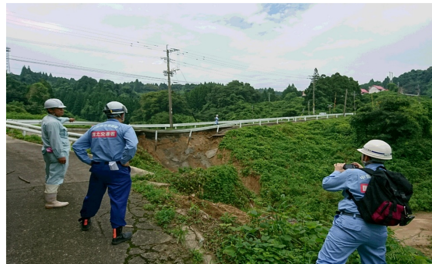
多久市番所での被災状況調査(道路調査1班)
