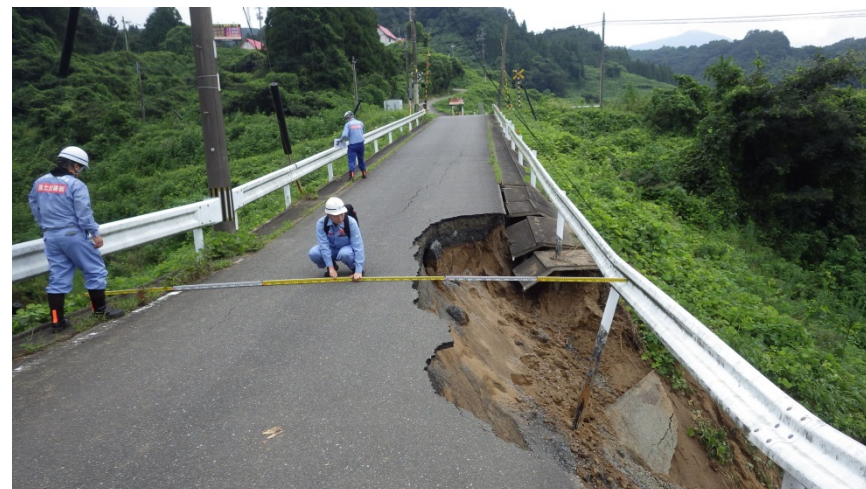
多久市での被災状況調査（道路調査1班）
