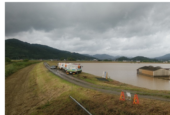
排水ポンプ車配置状況 （佐賀県杵島郡白石町下箕具付近）
