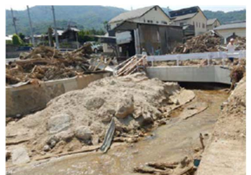
土石災害による土砂堆積の状況(広島県安芸郡坂町)
