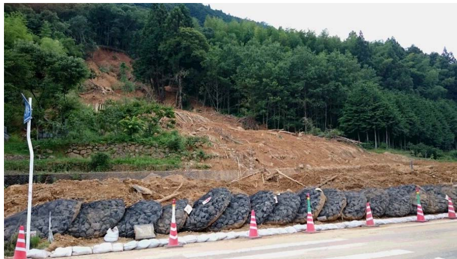
土砂崩落箇所 (国道197号)
