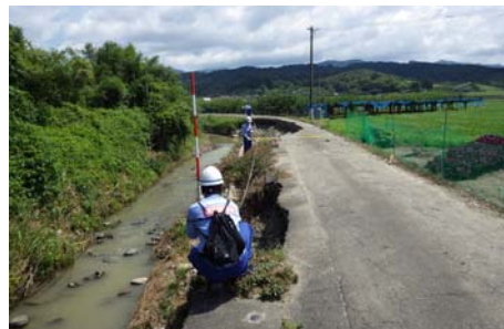
【被災状況調査(九州北部豪雨)】
