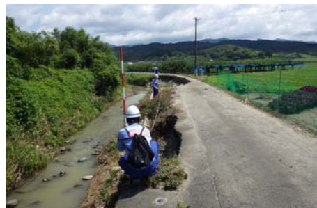
【被災状況調査(九州北部豪雨)】
