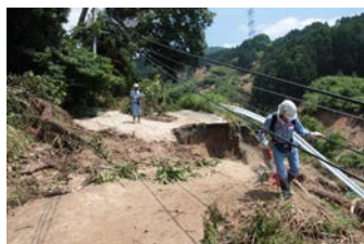
【7/13 県道588号の被災状況を調査(道路調査班)】
