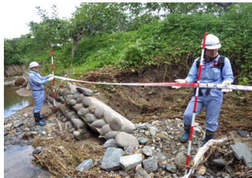
【7/11 重防川の被災状況を調査(河川調査班)】
