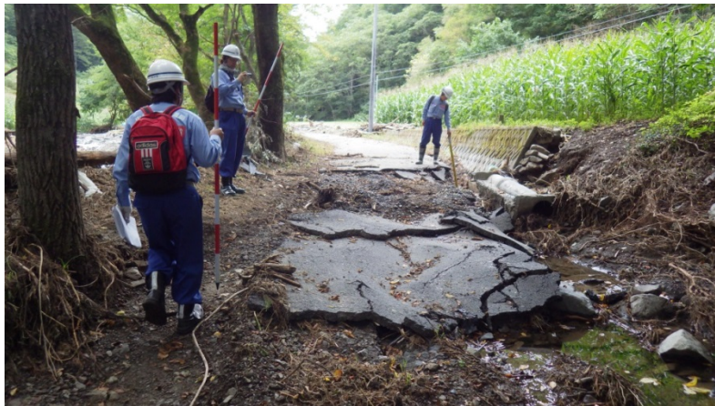
岩泉町南沢地区町道被災状況調査
