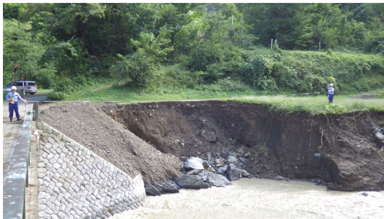
岩泉町見内川地区被災状況調査(1)
