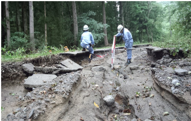
宮古市田老地区の道路被災調査
