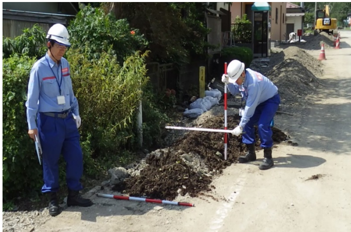
釜石市甲子町土砂堆積状況調査
