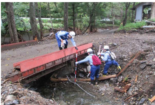
岩泉町小川地区被災状況調査
