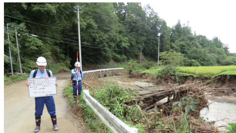
久慈市夏井川地区被災状況調査
