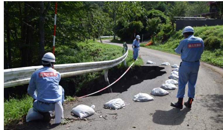
岩泉町大久保地区町道被災状況調査
