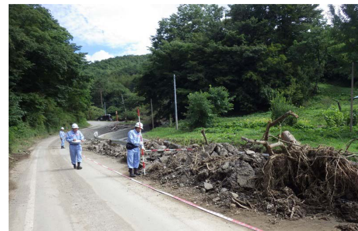
岩泉町大久保地区町道被災調査
