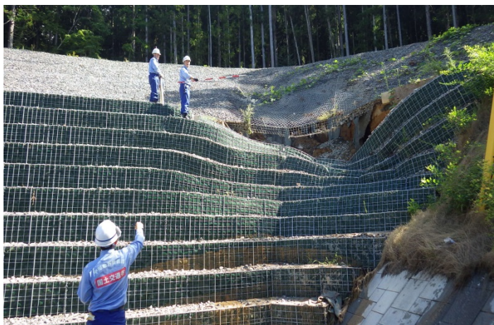
宮古市重茂地区 被災状況調査
