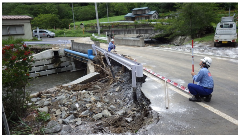
岩泉町見内川地区被災状況調査(2)
