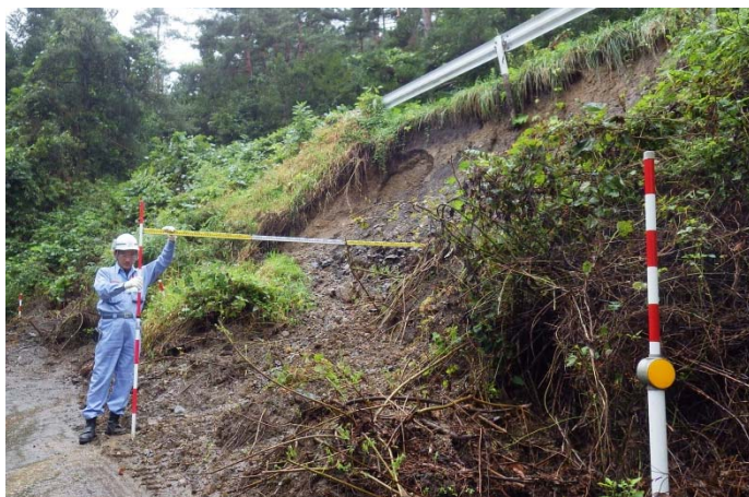
岩泉町で町道の被災状況調査
