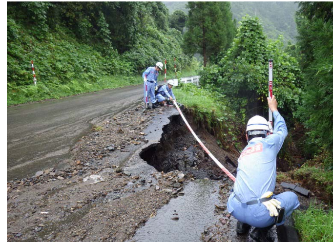
岩泉町で町道の被災状況調査
