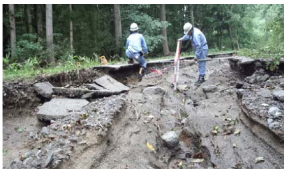
【宮古市田老地区の道路被災調査】
