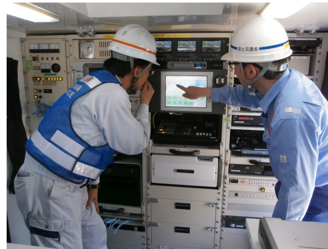
衛星通信車内において機器の調整
