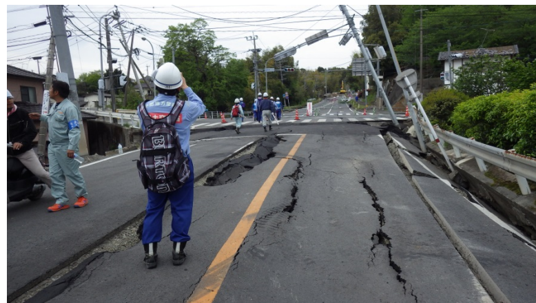
被災状況調査(益城町)
