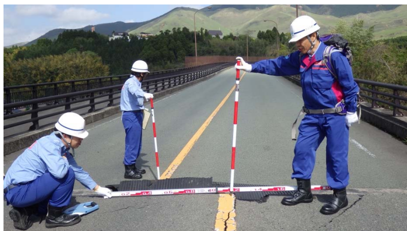
大切畑大橋被災状況調査その1
