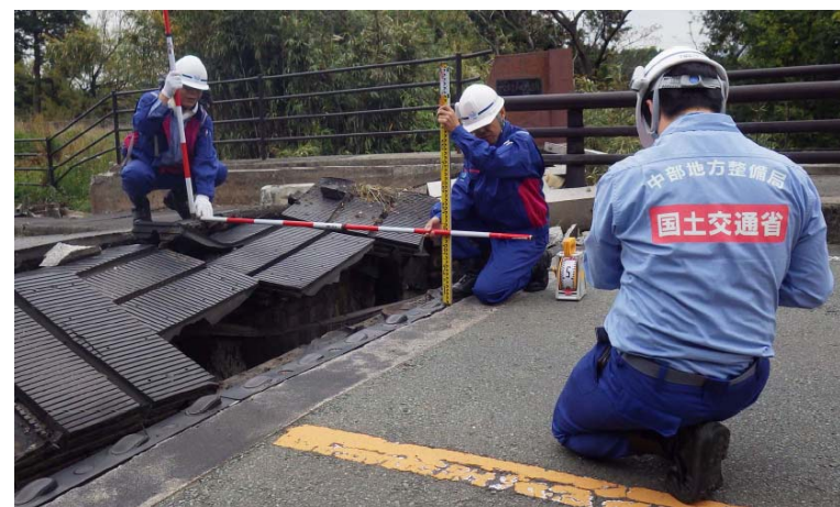
被災状況調査(大切畑大橋)
