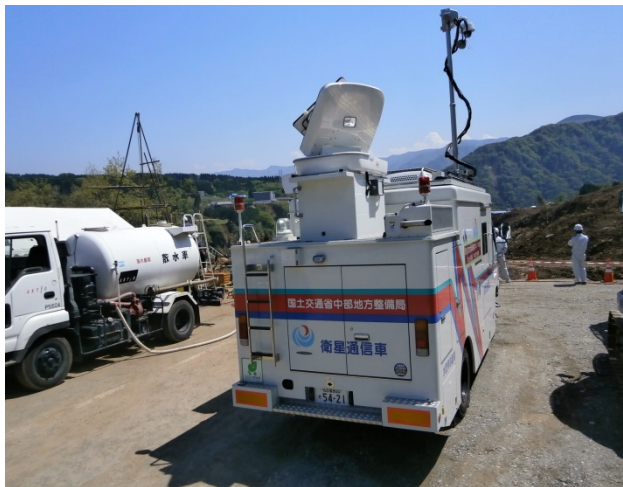
阿蘇大橋付近における衛星通信車設置状況
