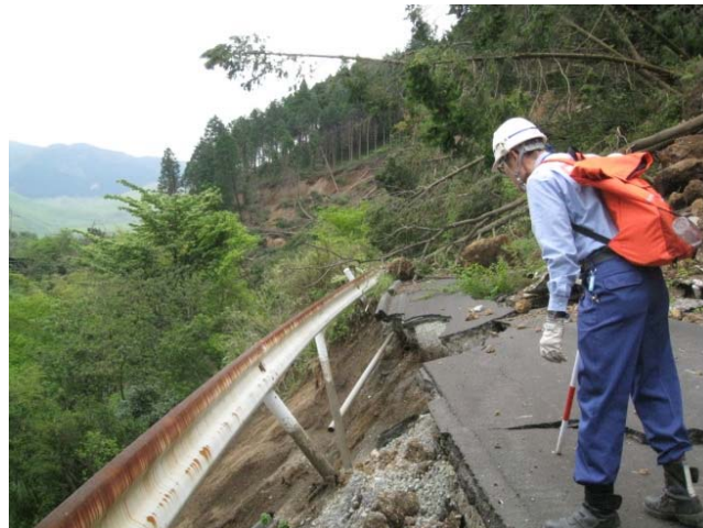
西原村大切畑地区被災状況調査
