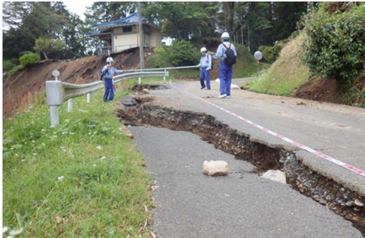
道路の被災状況調査(村道堀北・多々良線)
