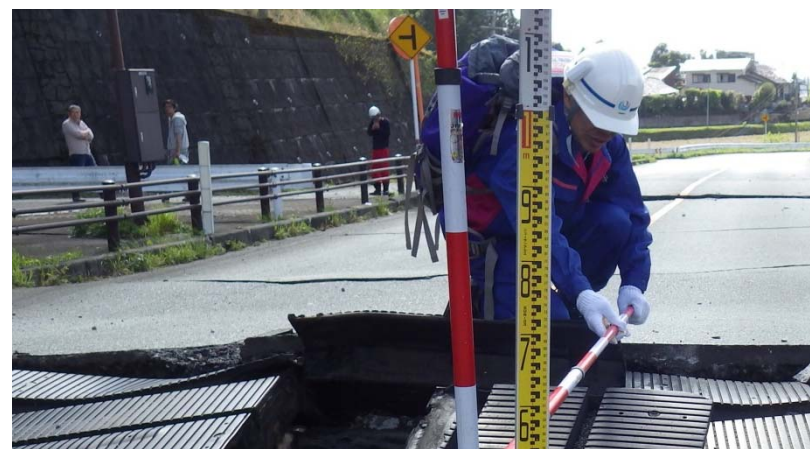
大切畑大橋被災状況調査その2
