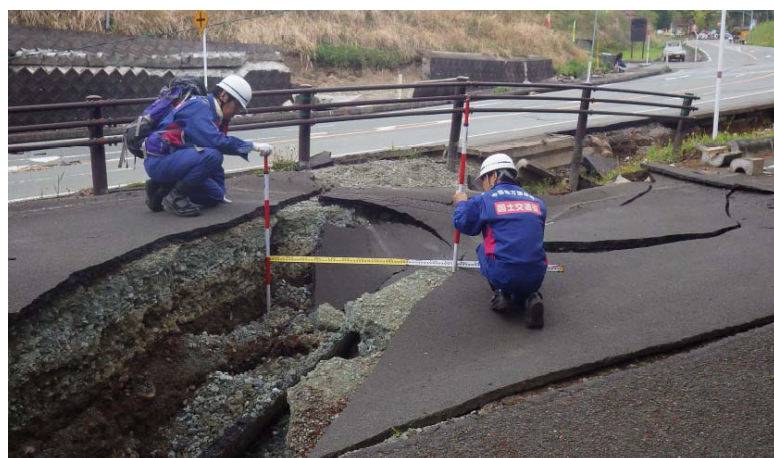
被災状況調査(大切畑大橋)
