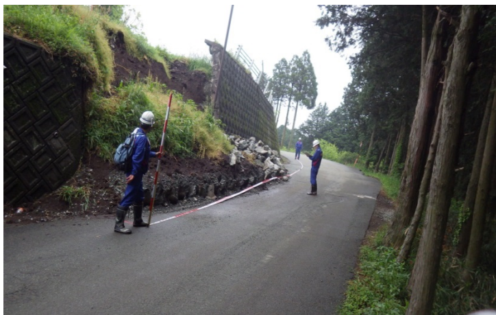
道路の被災状況調査(西原村道万徳・袴野線)
