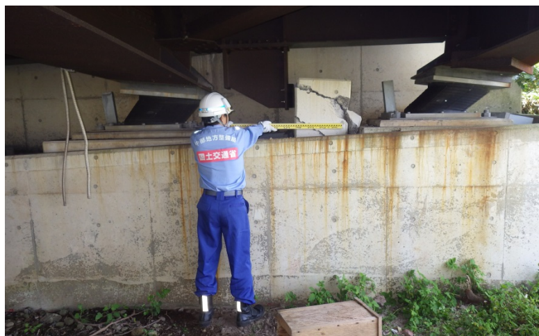
橋梁被災状況調査(県道28号)
