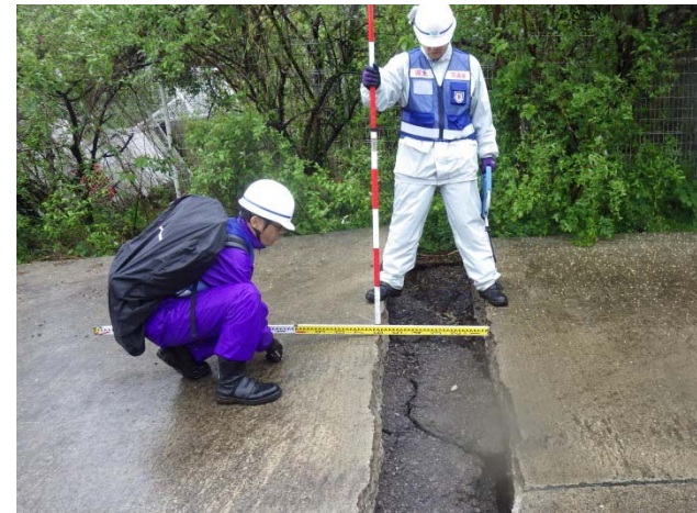
県道28号被災状況調査
