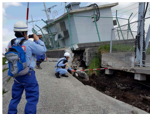
南阿蘇村 夜峰山被災状況調査
