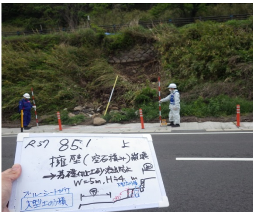
道路調査班から応急作業の提案
