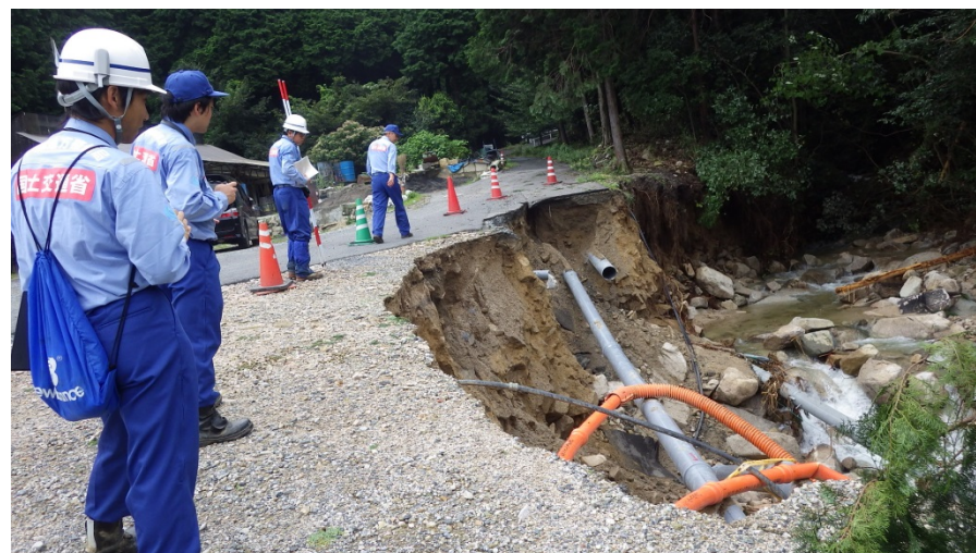
被災箇所調査の実施(天竜川上流班)
