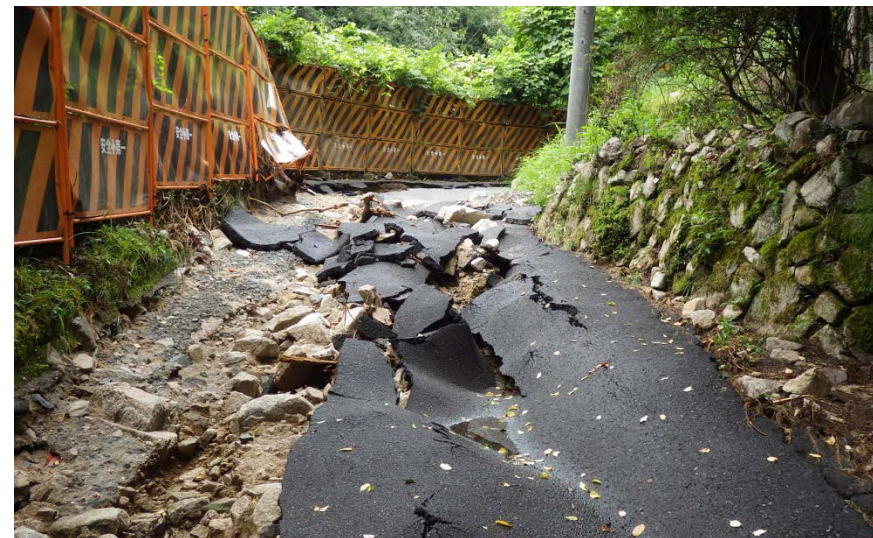
広島市安佐北区大林区の被災状況
