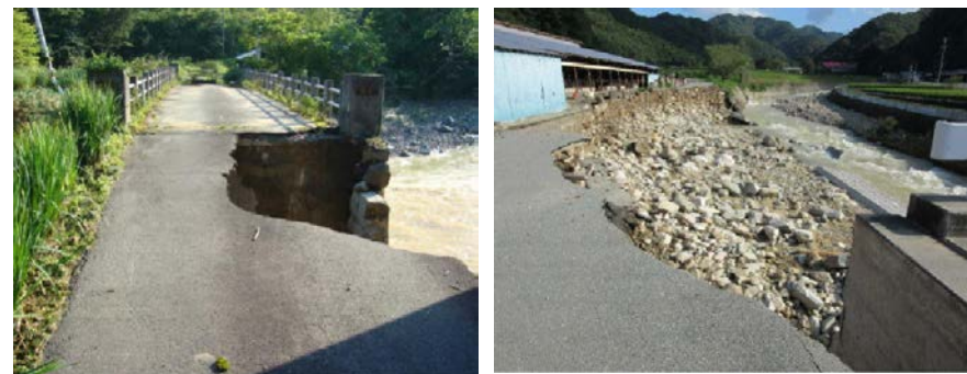
高山市内河川被災状況
