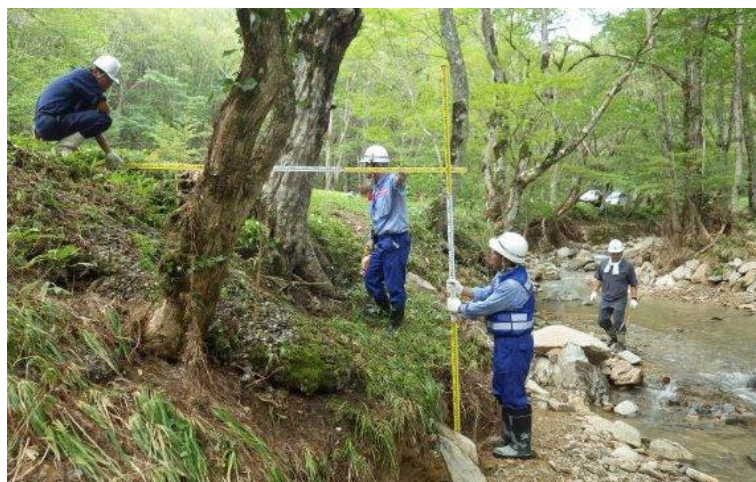
馬瀬川支川(清見町櫛谷) 被災状況調査
