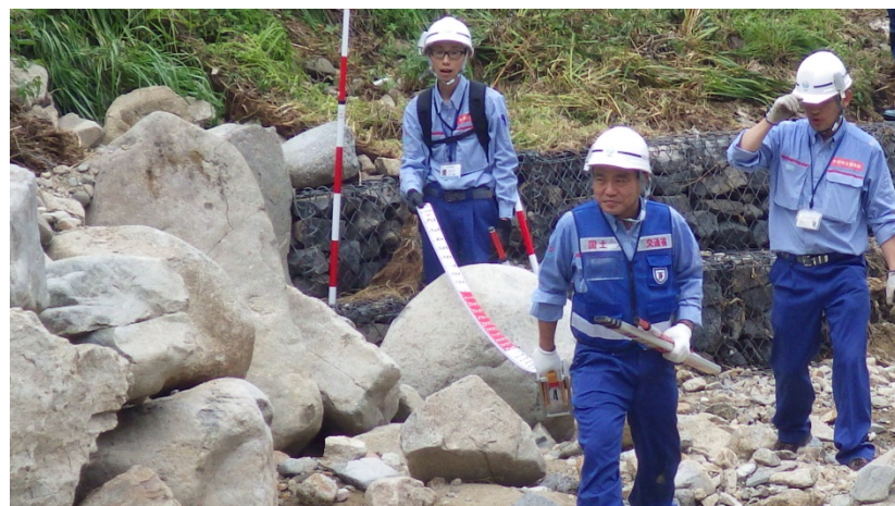
小井戸谷川(清見町坂下)被災状況調査
