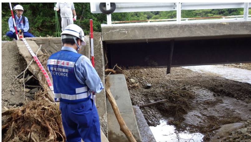
中野谷川(清見町巢野俣)被災状況調査
