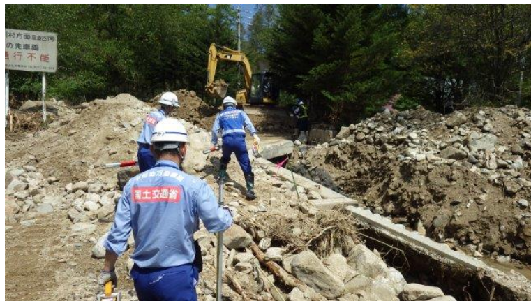
南平谷川(清見町櫛谷) 被災状況調査
