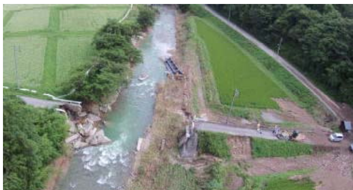
【宮前橋被災状況】
