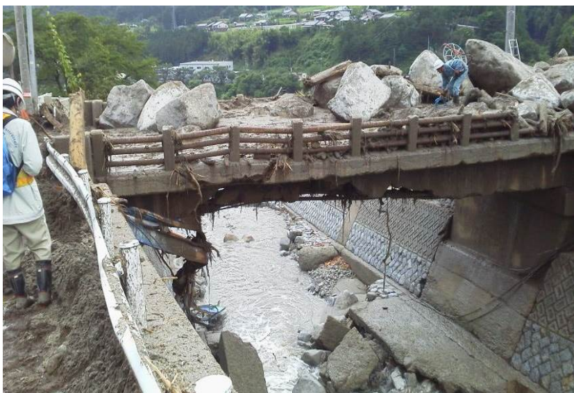
被災直後の梨子沢橋
