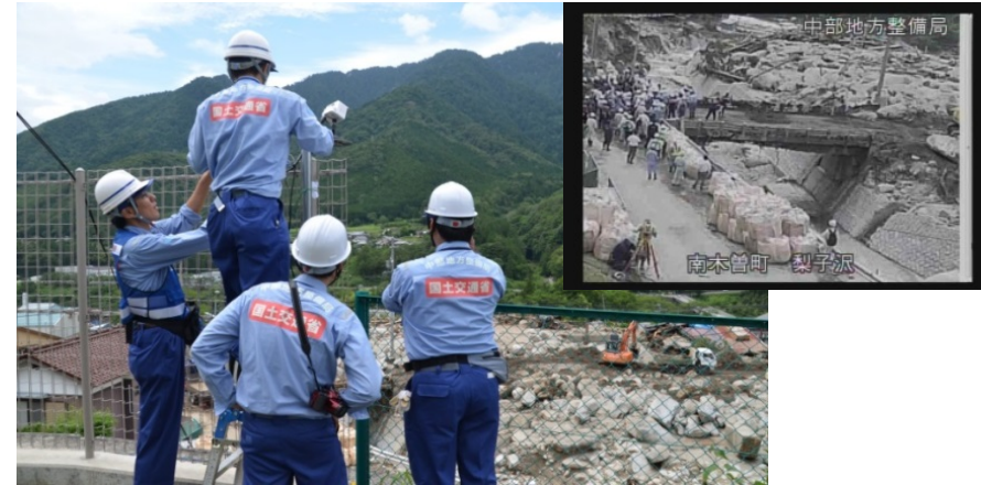
溪流状態監視のためのWEBカメラを設置、南木曾町へも映像配信
