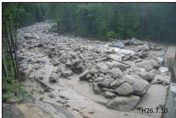
土砂堆積状況(梨子沢第2砂防えん堤)
