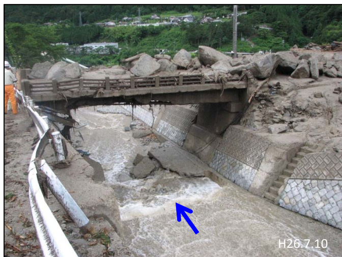
■梨子沢橋 被災状況
