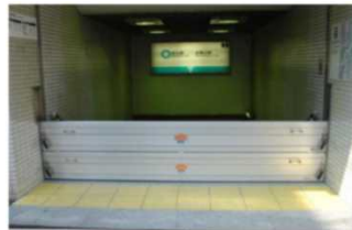
地下駅出入口 止水板
