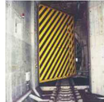
トンネル防水ゲート
