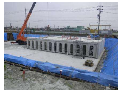
雨水貯留施設の整備 (北名古屋市)
