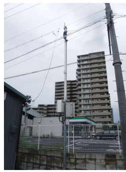
河川カメラの設置状況
