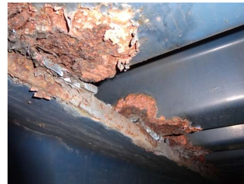
鋼製シェッド頂版の腐食状況
