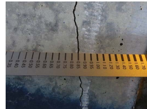
大型カルバート側壁のひびわれ状況
