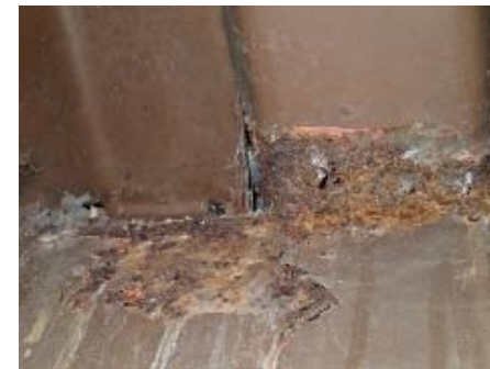
主桁及び床版の腐食状況
