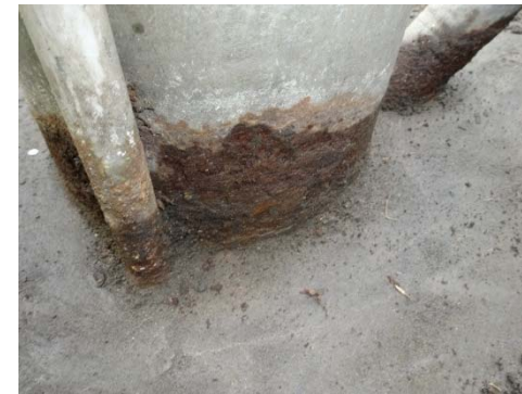
柱基部の腐食状況
