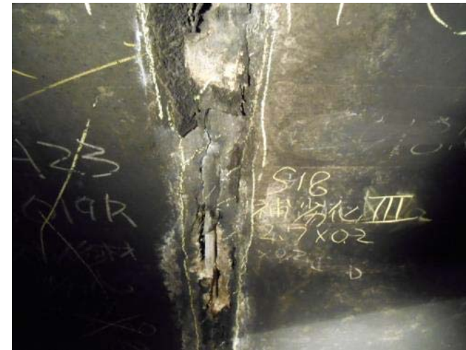
判定区分Ⅲの状況（アーチ部覆工コンクリートのうき）
