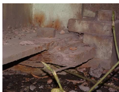
支承部の腐食
