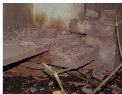
支承部の腐食
