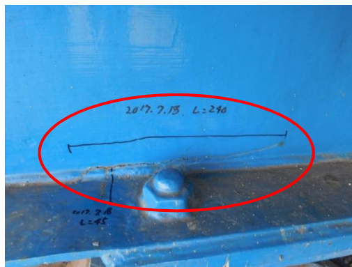
主桁の亀裂発見（H29年7月18日）
