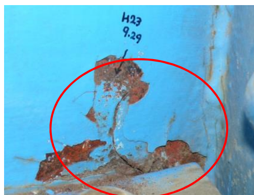
主桁の亀裂発見（H23年9月29日）
