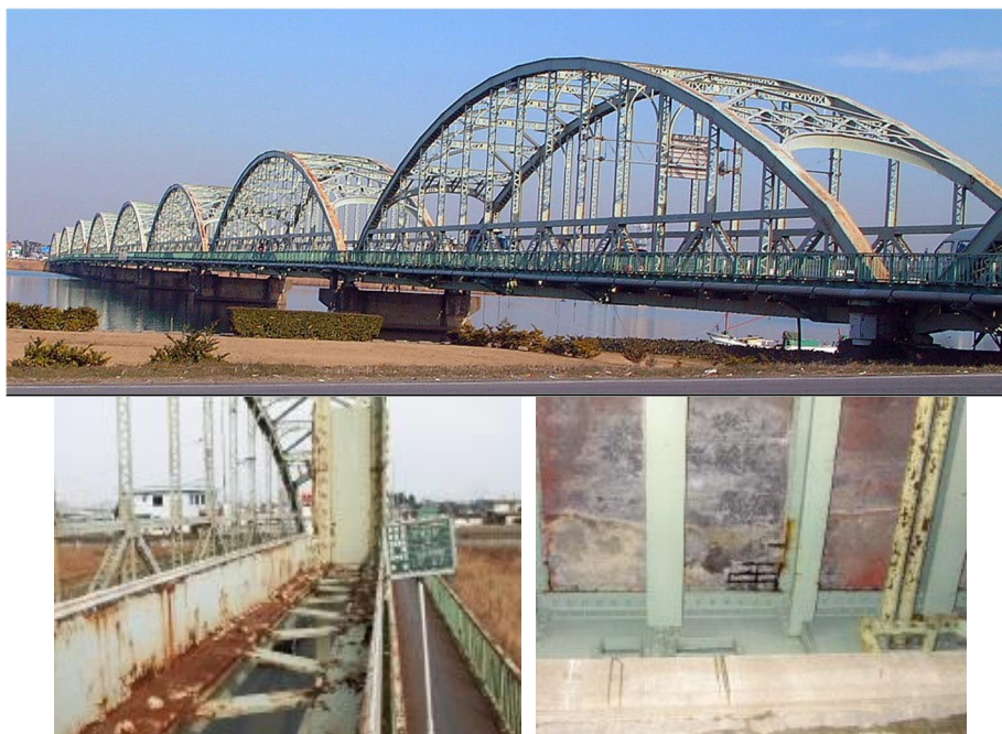
鋼部材、床版の劣化
