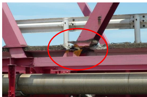
斜材の破断発見（H19年6月20日）
