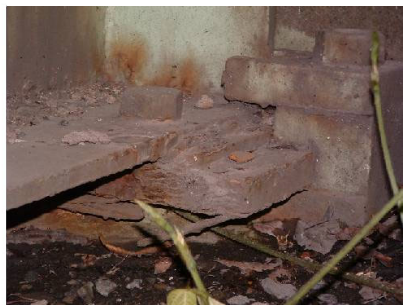
支承部の腐食
