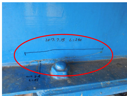
主桁の亀裂発見(H29年7月18日)
