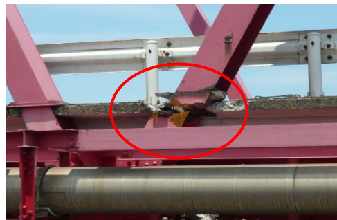
斜材の破断発見(H19年6月20日)
