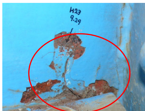
主桁の亀裂発見(H23年9月29日)
