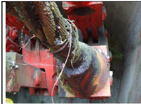
メインケーブルの損傷
