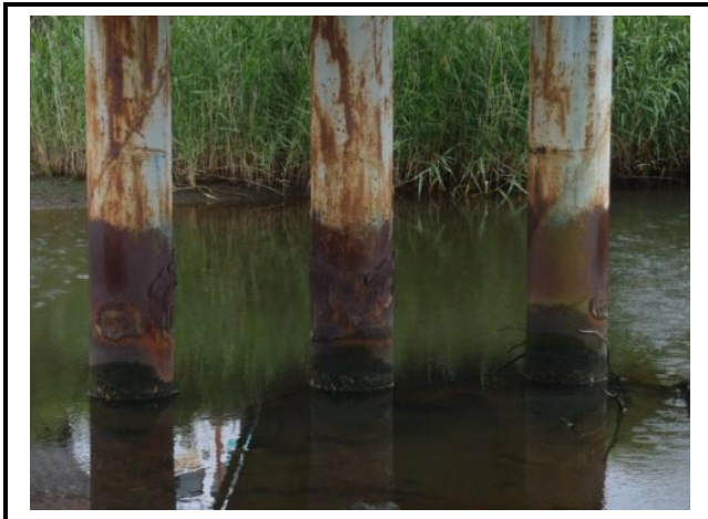
橋脚の損傷 (H22.6)
