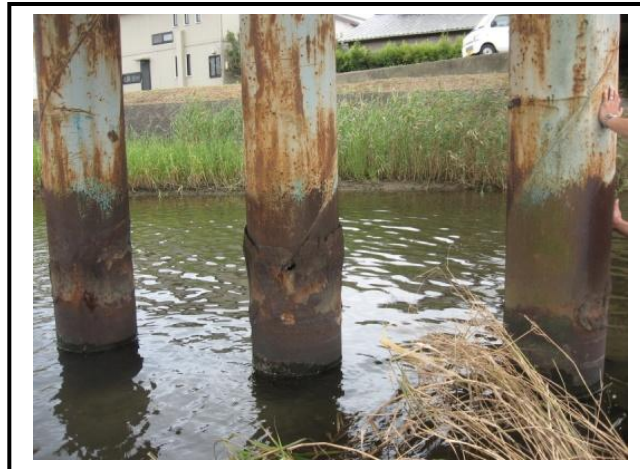
橋脚の損傷 (H23.9)
