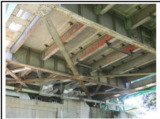
主桁・横桁の腐食
