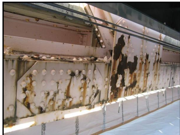
下弦材の損傷
