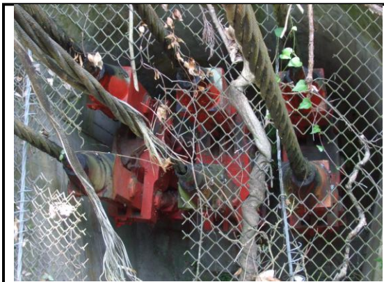
メインケーブルの損傷
