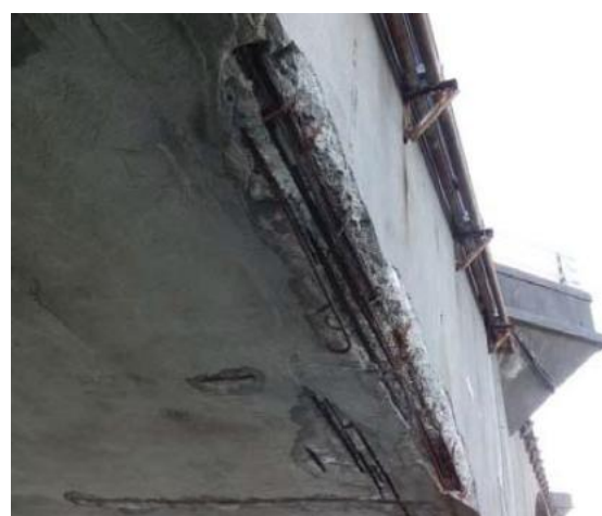
アーチ縁端部の剥離・鉄筋露出
