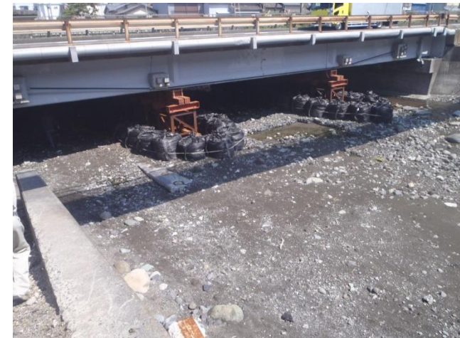
主桁の異常なたわみ（待受ベント設置）
