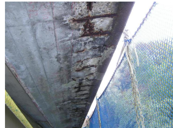
張出床版の剥離・鉄筋露出
