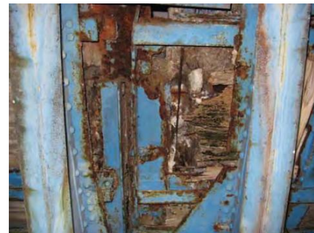
床版の剥離・鉄筋露出
