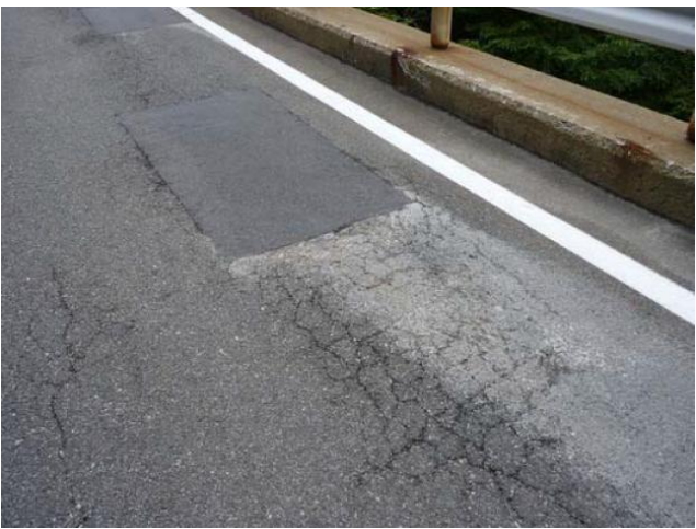
舗装の亀甲状ひびわれ
