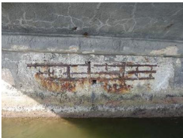
橋脚壁部の剥離・鉄筋露出
