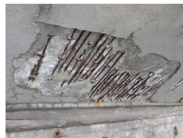
アーチ下面の剥離・鉄筋露出
