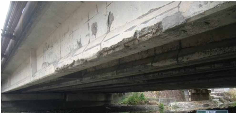
主桁のひびわれ、剥離・鉄筋露出
