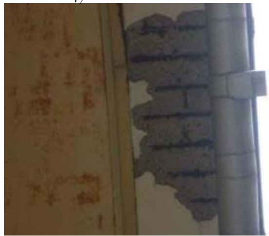
RC床版張り出し部の剥落箇所
