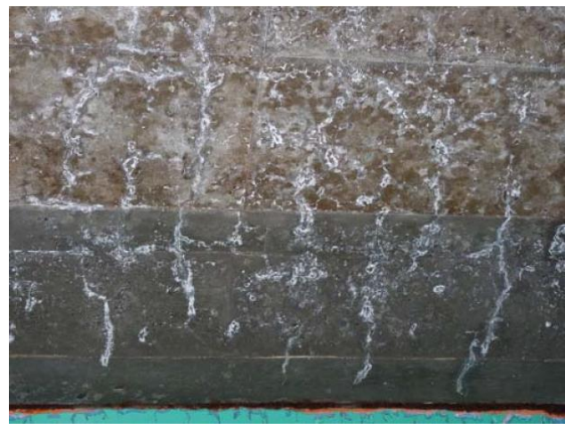
RC床版のひびわれ
