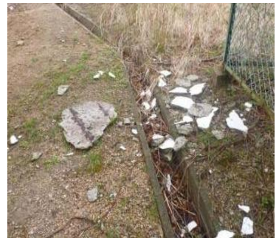
剥落したコンクリート片
