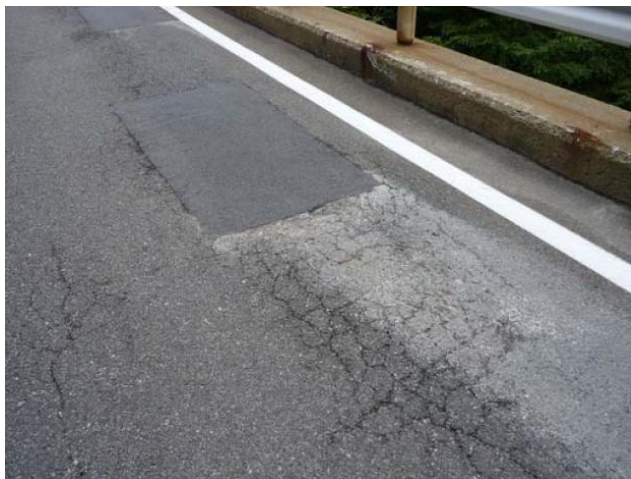
舗装の亀甲状ひびわれ
