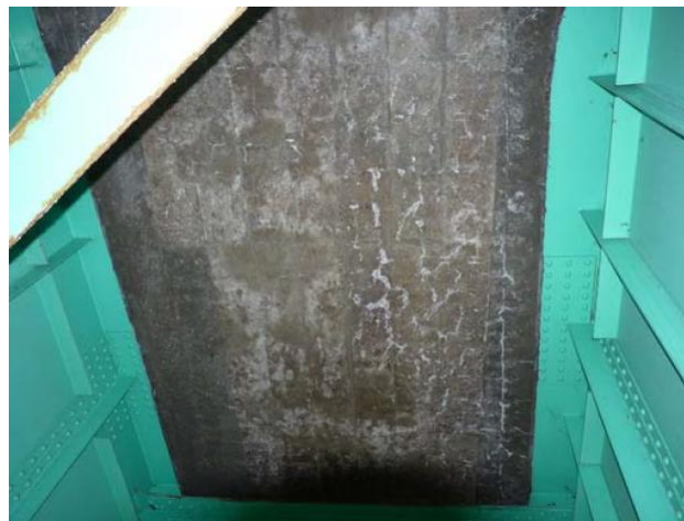
RC床版の亀甲状ひびわれ、漏水・遊離石灰
