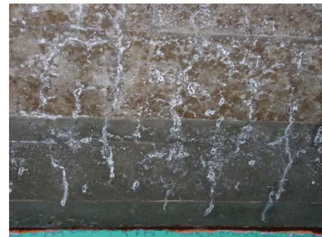
RC床版のひびわれ
