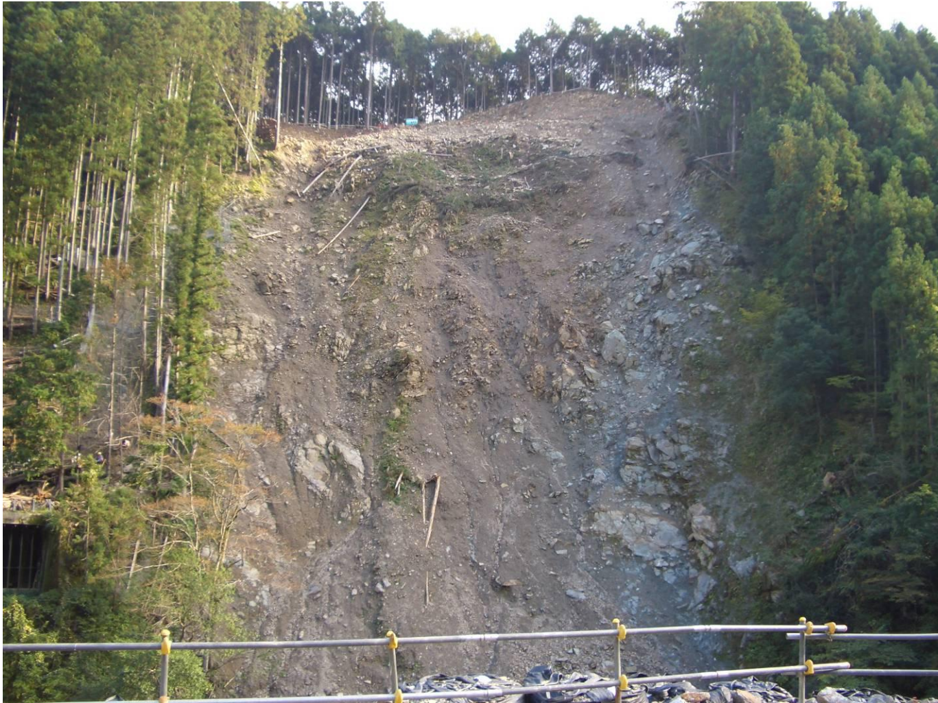
外帯側(三波川帯)で発生した大規模な崩壊
