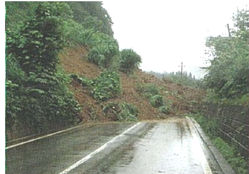
▲土砂崩落による通行止め状況
