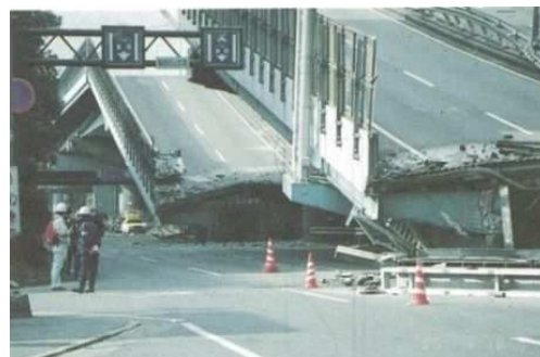
写真-5-Ⅱ-1 単純桁の落橋
