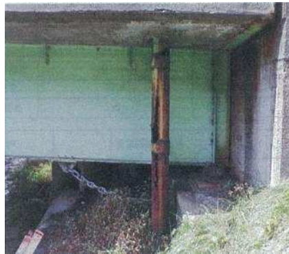
写真-5-Ⅲ-3 排水管 (鋼管) の腐食例
