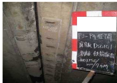
写真-5-Ⅲ-1 中央分離帯部（狭隘部分）の損傷
