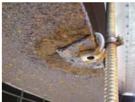
写真-5-Ⅲ-5 異種金属反応による腐食の例
