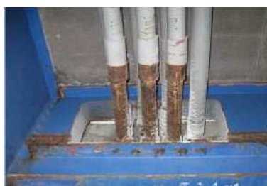
添架物の鋼部材の腐食
