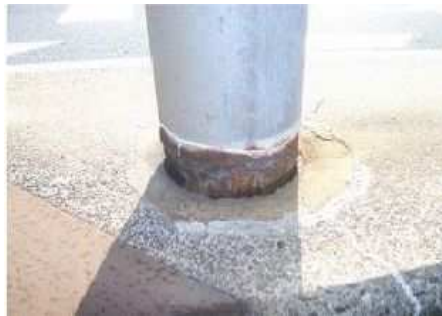
写真-5-Ⅲ-2 支柱の腐食の例
