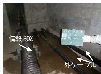
添架物による箱桁内部の滞水
