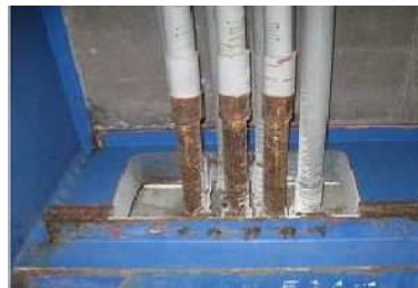
添架物の鋼部材の腐食
