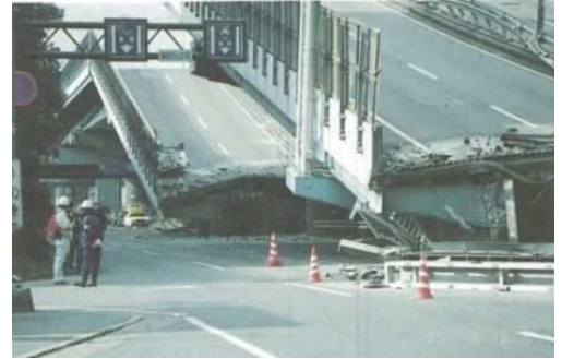
写真-5-II-1 単純桁の落橋
