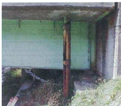
写真-5-III-3 排水管 (鋼管) の腐食例
