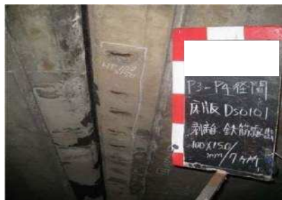
写真-5-III-1 中央分離帯部（狭隘部分）の損傷
