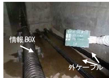
添架物による箱桁内部の滞水
