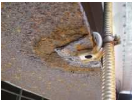
写真-5-III-5 異種金属反応による腐食の例
