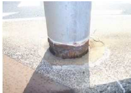
写真-5-Ⅲ-2 支柱の腐食の例
