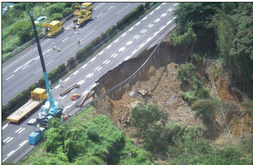
図-4-Ⅱ-1 東名牧之原SA付近の盛土崩落状況
