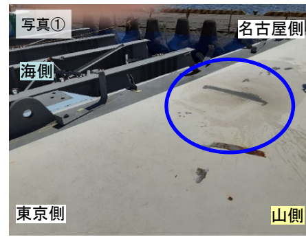
写真①橋桁上フランジに凹み
