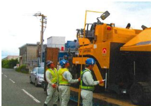
取組② 積荷安全点検と高さ計測状況 (ドライバー、誘導員)
