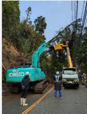
石川県穴水町 県道303号
