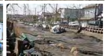
液状化の被災状況調査(千葉県・小野川)
