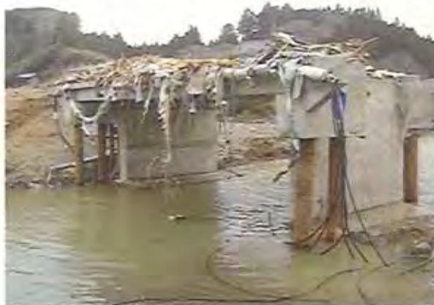
▲被災状況（橋台背面盛土流出）
