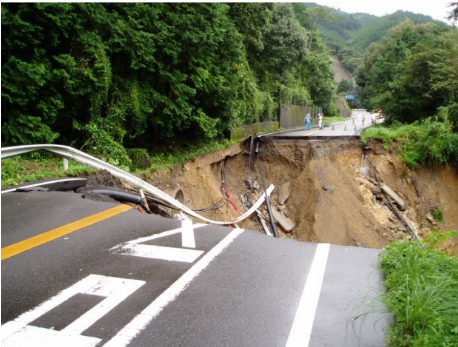
台風21号(平成16年)による被災 (国道42号三重県海山町)
