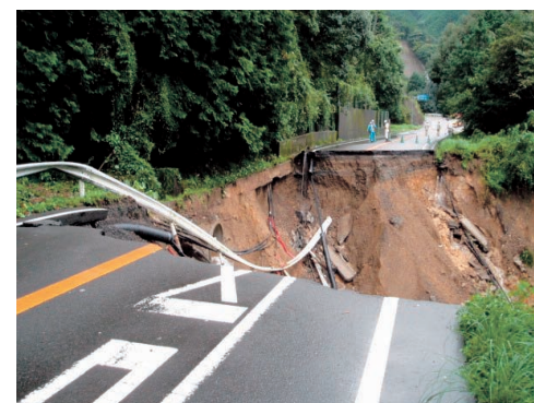
台風21号(平成16年)による被災(国道42号三重県紀北町)
