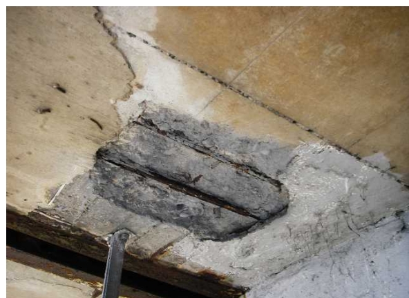
出典：東名高速道路 岡崎IC～豊田JCT間の橋梁劣化状況(中日本高速道路株式会社)
