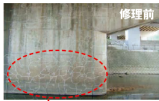
コンクリートの化学反応によりひびわれや鋼材の露出が発生
