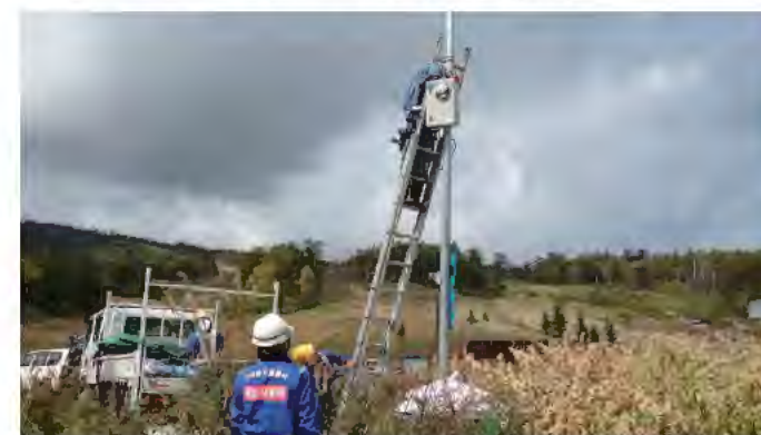
監視用のWEBカメラの設置(10月9日撮影)
