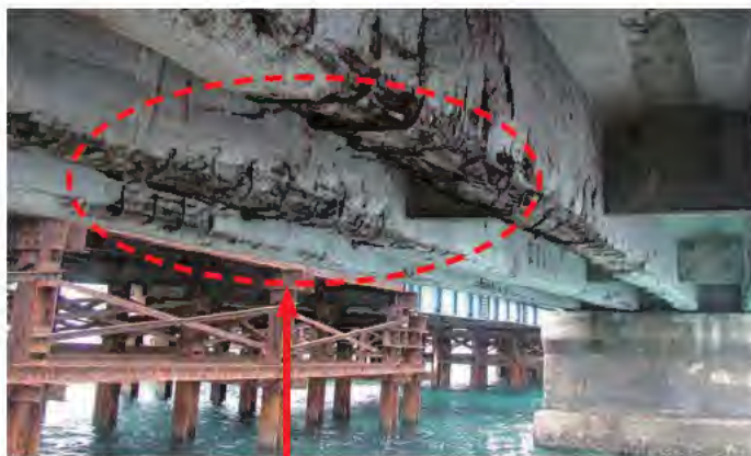
海からの塩分により、コンクリートがはがれ落ちた
