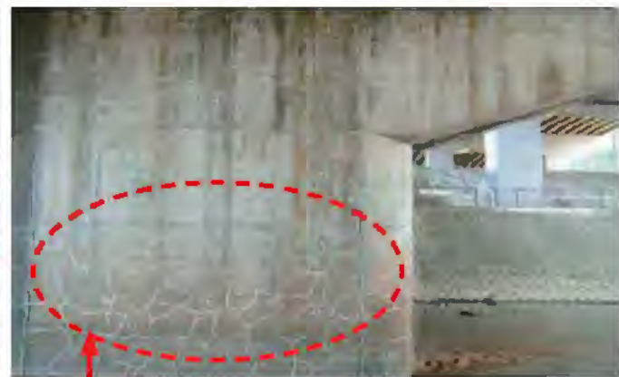
コンクリートの化学反応によりひびわれが発生
