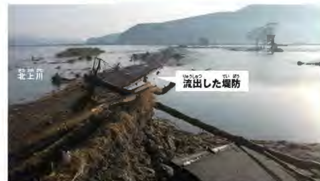
道路兼用の河川堤防が津波により流出(宮城県石巻市)
