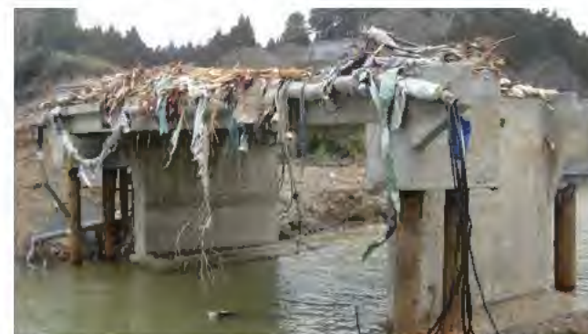
橋が津波により流出(国道45号・宮城県気仙沼市)
