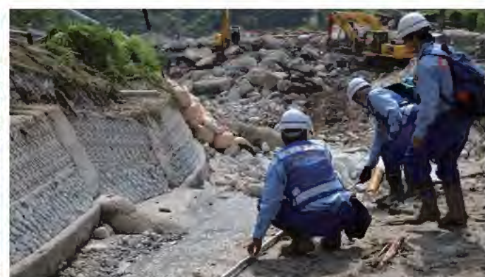
土石流災害の被害状況調査(7月11日撮影)
